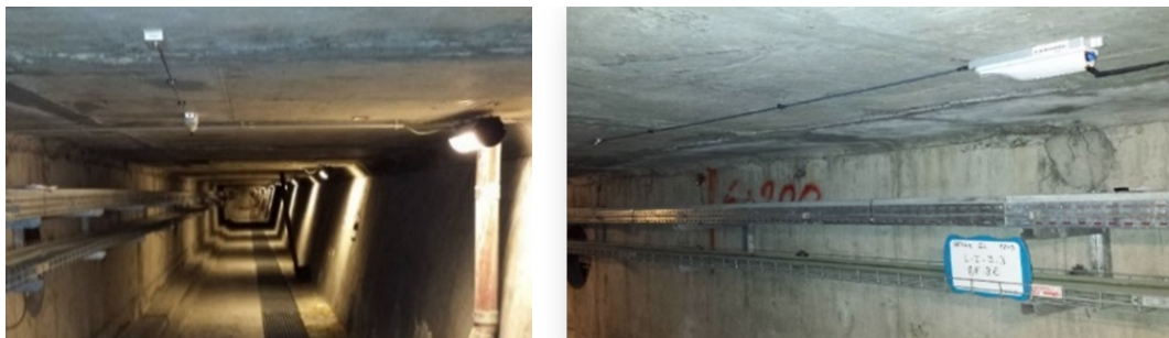
FIGURE 1. Vues de l'une des gaines avec une Corde Optique LIRIS en sous-face de la dalle
