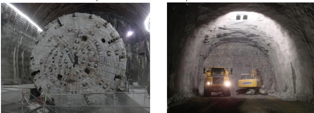
FIGURE 2. Les différentes méthodes de creusement des tunnels : conventionnelle à droite (Tunnel de Talant, LiNo (Liaison Nord de l'agglomération dijonnaise)) et mécanisée à gauche – tunnelier (TEL).
