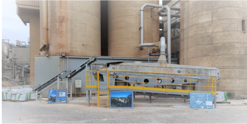
FIGURE 3. Pilote FastCarb – Sécheur à lit fluidisé, usine Lafarge de Val d’Azergues (Rhône).
