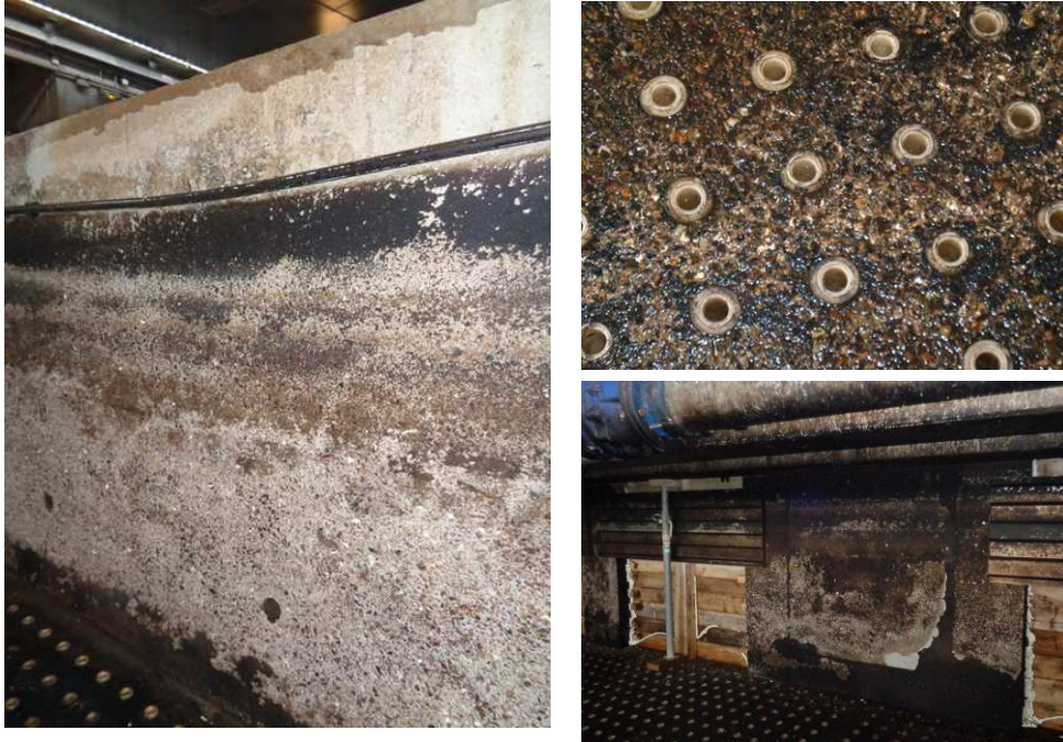
FIGURE 1. Photographies de la partie supérieure d'un bassin de traitement biologique aéré – à gauche la paroi du bassin, en haut à droite, le plancher du bassin et en bas à droite la paroi avec la sortie du bassin.
