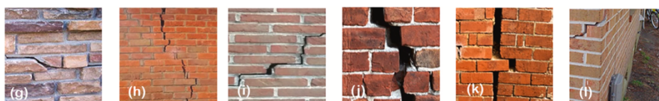
FIGURE 2. Exemples de fissures sur des structures en maçonnerie aisée [Dais et al. , 2021]
