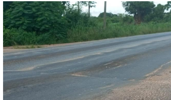
FIGURE 3. Dégradation observée sur l'axe Bopa, Bénin (2022)
