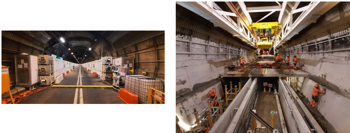
FIGURE 10. A gauche, les équipements indispensables à la décontamination pour les travaux en présence d’amiante. A droite, travaux de remplacement de la dalle de chaussée
