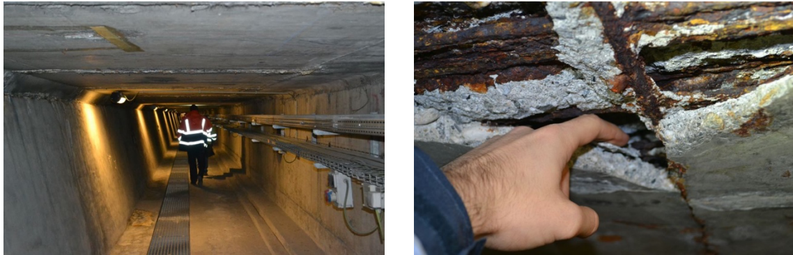
FIGURE 8. Investigations dans les gaines d'air frais et air vicié : identification des zones de corrosion des aciers induisant un éclatement du béton dans la dalle de chaussée
