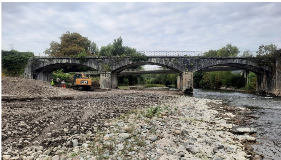
FIGURE 1: Pont d'Osserain avant démolition ("Dolmen – Développement d'Outils et de Logiciels pour la Maçonnerie Existante et Neuve,").
