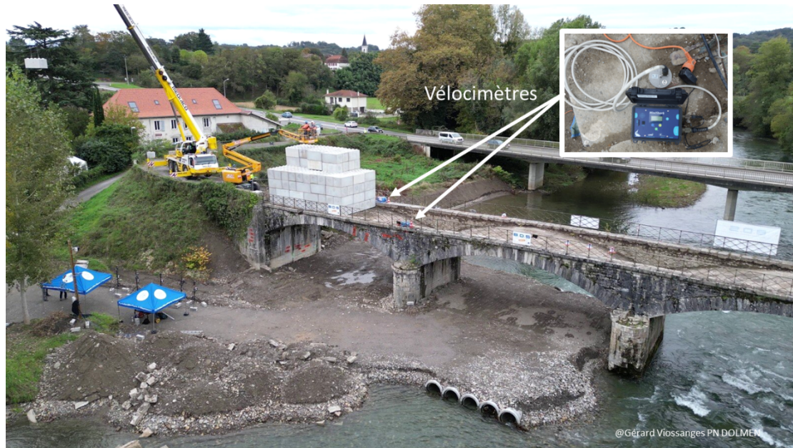
FIGURE 1 : Vue aérienne du pont d'Osserain (Gérard Viossanges) lors de la fin de la phase de chargement. En médaillon : zoom sur une station sismologique, avec vélocimètre, câble sismologique et numériseur.
