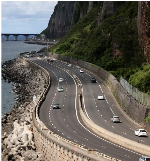
FIGURE 6. Photo représentative du segment (plus récente, d'après Imaz Press Réunion, 17 avril 2022) https://imazpress.com/actus-reunion/la-route-du-littoral-est-rouverte-sur-4-voies
