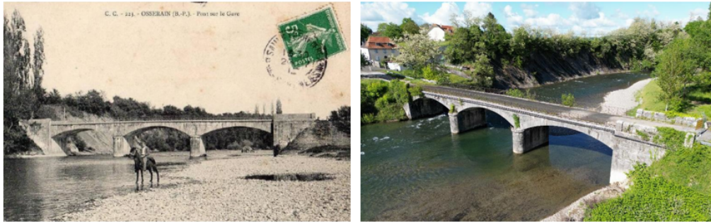
FIGURE 1. Pont en maçonnerie d’Ossevain (Pyrénées-Atlantiques, France) : carte postale d’archives (à gauche) et prise de vue de mai 2023 (© G. Viossanges) (à droite)
