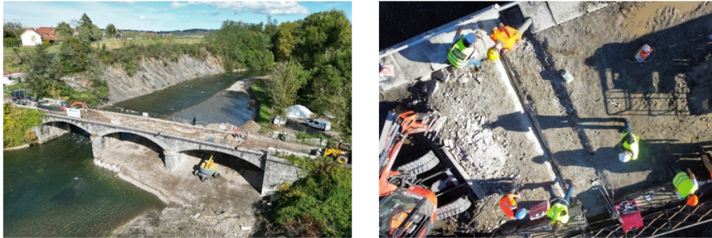
FIGURE 3. Opération de vidage des remblais et de sciage de la voûte conformément au plan de chargement validé par le GT Modélisation
