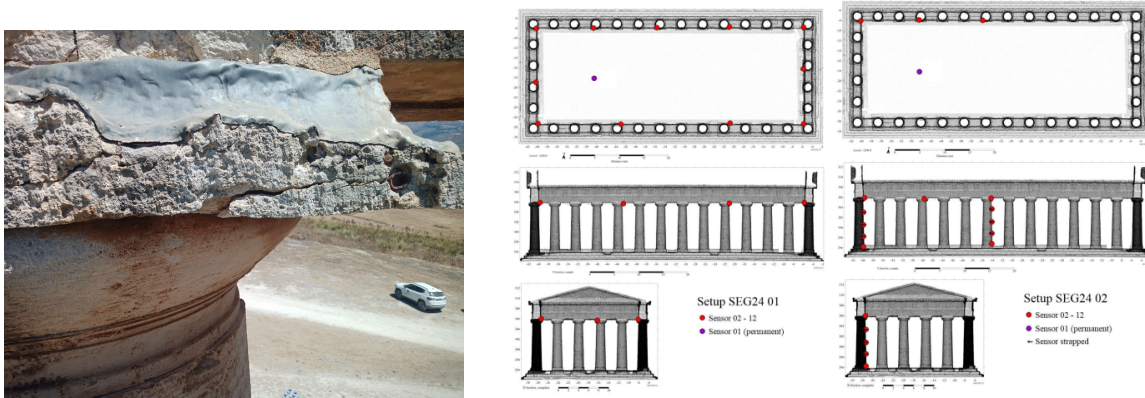
FIGURE 7. Érosion de la surface supérieure d'un abaque du temple d'Aphrodite (gauche). Proposition de placement de capteurs (en rouge) le long de colonnes, et au sommet de quelques abaques.
