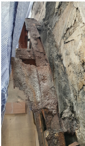
FIGURE 17. Structure métallique d'une des trois arches dans un état de dégradation avancé, visible après dépose des pierres (Sherlock Patrimoine)
