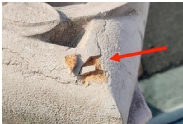
FIGURE 12. Composé orange sous une fissuration de la pierre (Sherlock Patrimoine)
