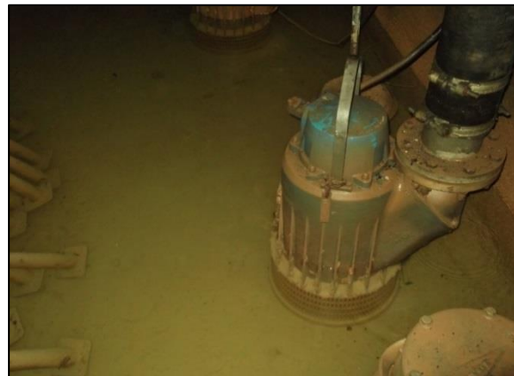
Figure 3. Eau d'infiltration pompée à Cité. Cuvette de cité. Juin 2013.
