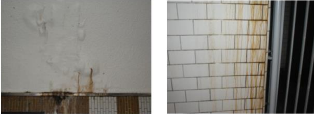
Figure 1. Les traces des infiltrations dans le tunnel de la station Cité. Juillet 2013.
