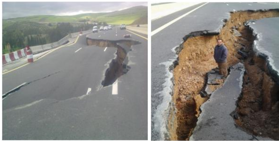
Figure 1. Déformation du corps de chaussée.
