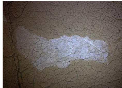
(b) Compresses de dessalement Stonevox mise en œuvre sur une maçonnerie en pierre
