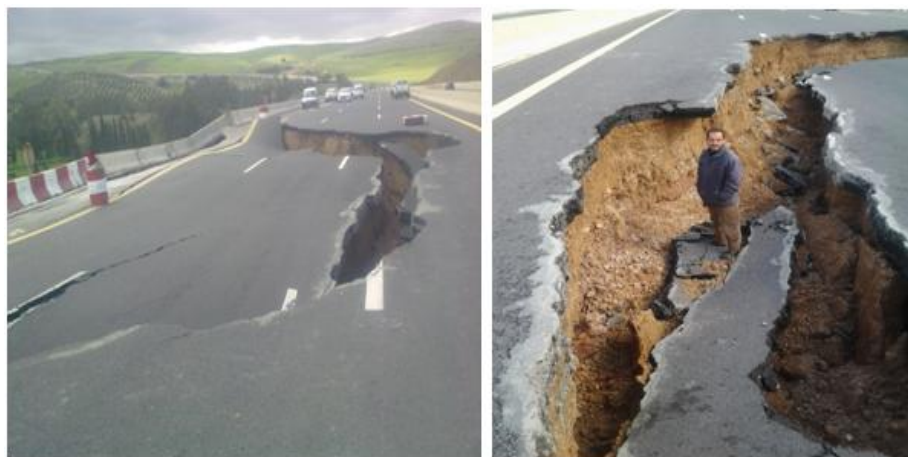
Figure 1. Déformation du corps de chaussée.
