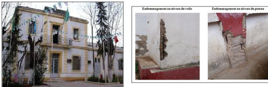
Figure 2 : 01) à gauche : façade principale du bâtiment étudié, 02) endommagement au niveau des éléments structuraux
